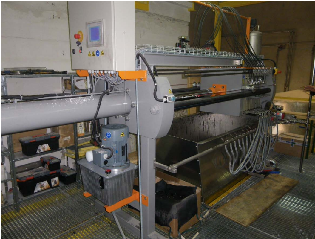
Abbildung 7: Plattenfilter im Einsatz
